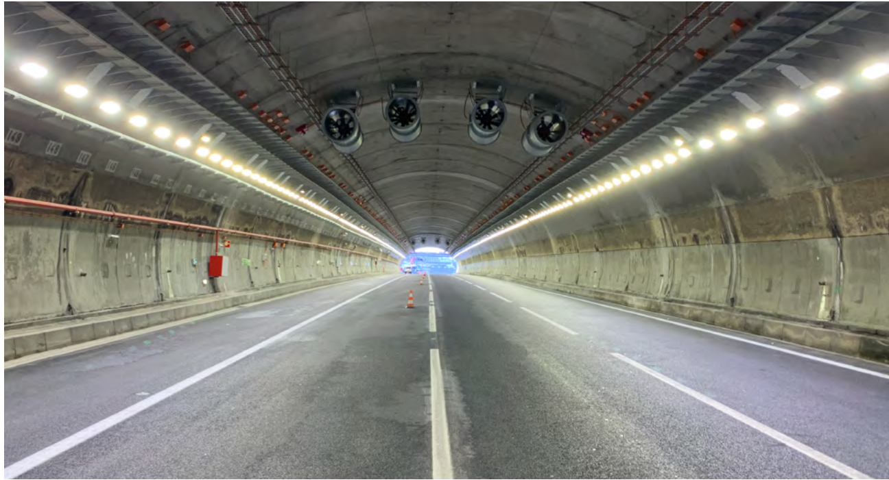
Instalações elétricas no Tunel de Montemor, MEEC.
