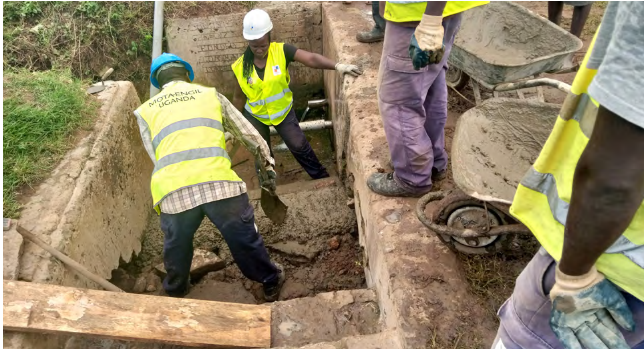
Obras de melhoria em fonte de água, na vila de Kapokin (Uganda).
