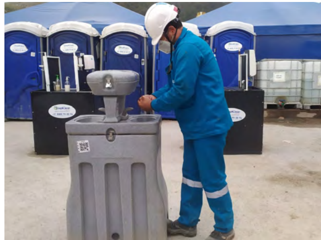
Pontos de água portáteis para lavagem regular das mãos, na obra da Estação Elevatória de Canoas (Colômbia).
