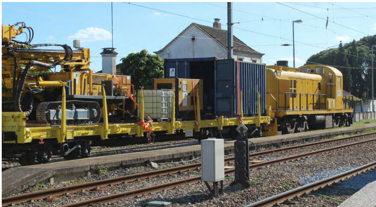
Projeto GroutRail – Reabilitação de Plataformas Ferroviárias, com tratamento de solos, MEEC (Portugal).
